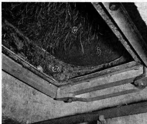
Bild 21. Blick von unten durch die Entnahmeöffnung des Gärfutterhochsilos mit Untenfräse nach Bild 20. Der Futterstock rutscht nicht nach, die Fräse läuft leer durch.
