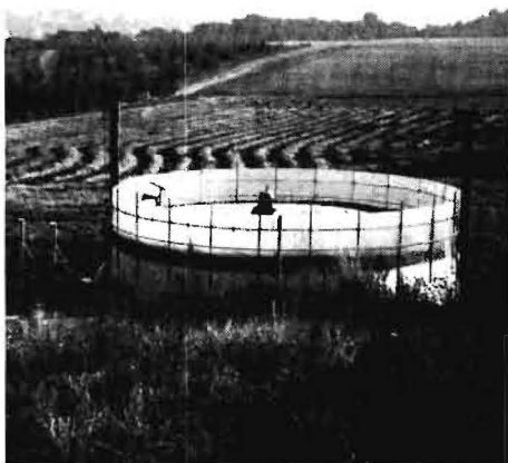
Bild 3: Einsatz des Umwälzbelüfters im Dungspeicherbehälter Während der Belüftung bildet sich eine Schaumschicht von 60 bis 70 cm Höhe. Zur Ausnutzung der vollen Lagerkapazität wurde für die Aufnahme des Schaumes ein Ring aus Kunststoff auf den Betonbehälter gesetzt
