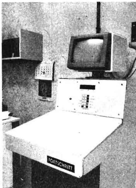
Bild 7 Datenerfassungsrechner DER01A in der Datenzentrale der Anlage
