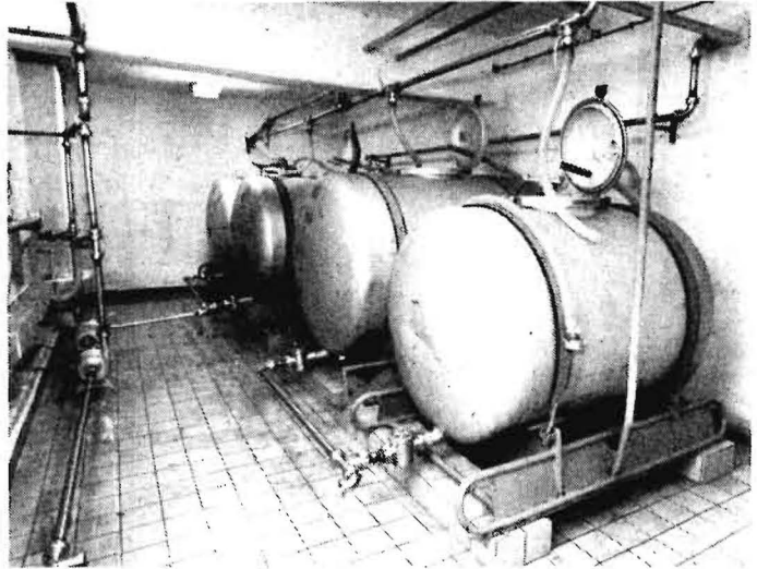
Bild 3. Behälter für die Zwischenlagerung
