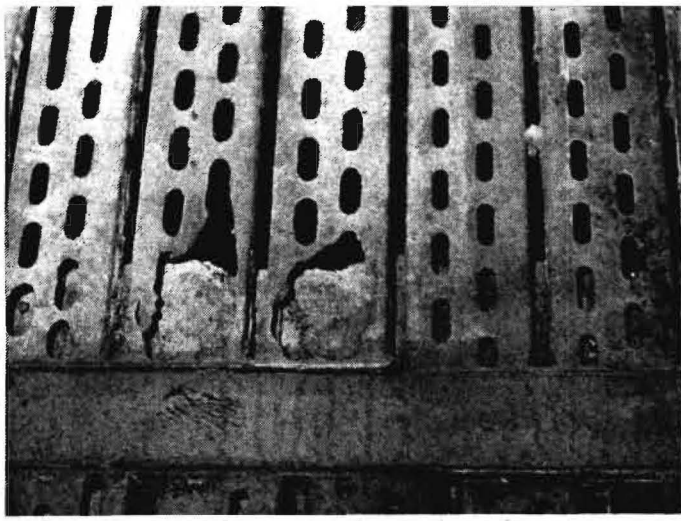
Bild 2. KTS-Spaltenfußboden mit deutlichen Locherweiterungen nach rd. 2-jährigem Einsatz in der Schweinemast bei Fütterung von Küchenabfällen
