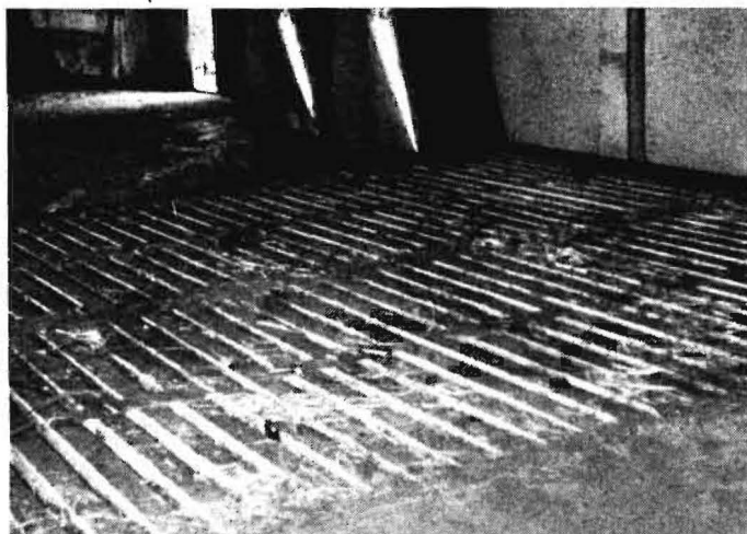
Bild 5. Vergrößerte Rostfläche auf Doppelkanalanlage
