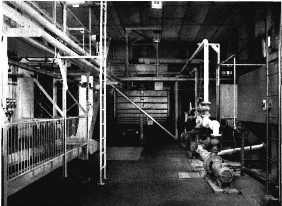
Bild 3. Blick in das Futterhaus der ZGE Schweine-Zucht- und Mastanlage Hoyerswerda-Kühnicht; links Zwischenlager L481A mit F929, hinten 2 Mischer L411 A02, rechts 2 Zwischenlager S10 (Foto: J. Böck)
