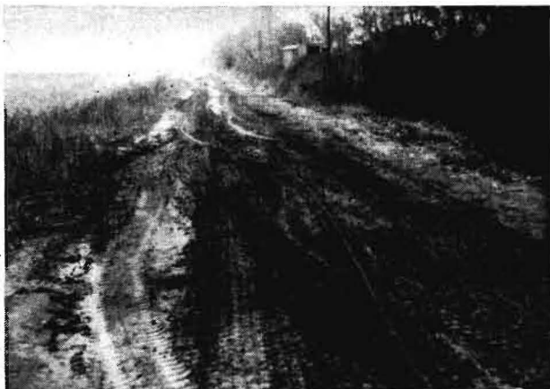
Bild 6. Spuren vom seitlichen Abgleiten der Fahrzeuge infolge der Aufweichung der Fahrbahnoberfläche
