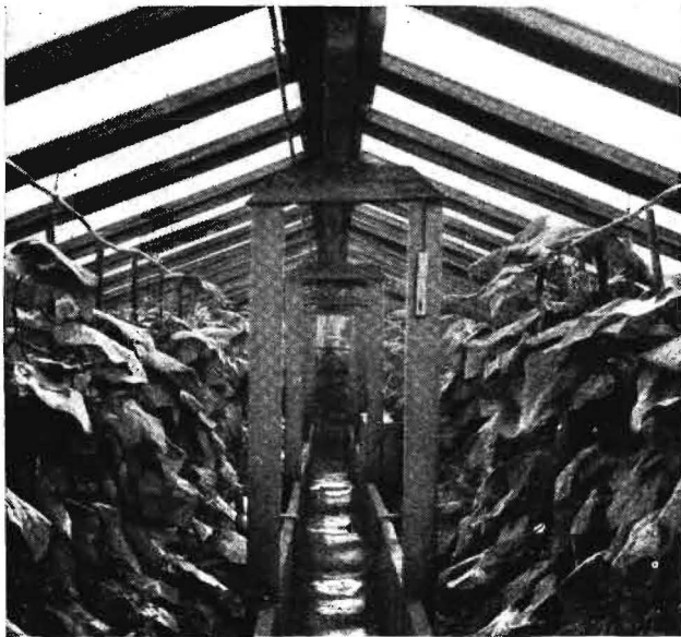
Bild 1 In ein Gewächshaus eingebaute Heizrohre
