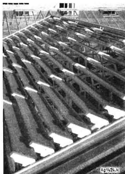
Bild 4. Die neuen automatisch zu öffnenden Lüftungs-Jalousien der bekannten Gewächshausfirma Weigelt , Niedersedlitz, fanden in Markkleeberg sehr starke Beachtung
