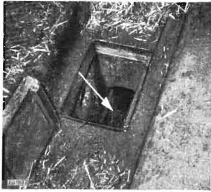
Bild 5. Abflußschacht mit Blick in das Schwemmrohr
