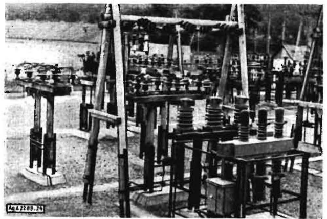
Bild 24. Freiluftstation des Wasserkraftwerkes Stablewskaia
