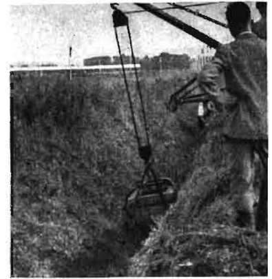
Bild 10. Schürfkübelbagger „Whitlock“ bei der Schürfarbeit. Der Kübel wird von dem über die Rolle des im Hintergrund sichtbaren zweiten Auslegers laufenden Drahtseil nach hinten gezogen
