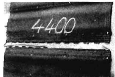
Bild 7. Zerstörung des Einstab-Scharnierverschlusses
