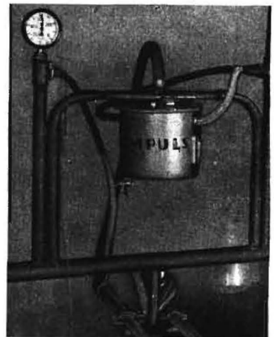
Bild 4. Das Milchförderventil wird an das Ende der Milchleitung angeschlossen
