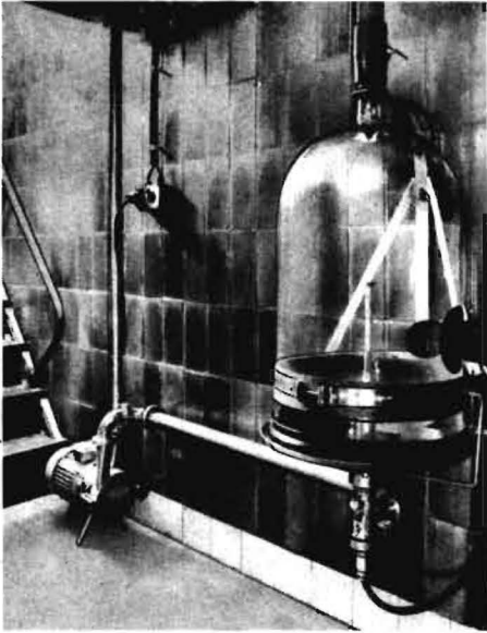
Bild 5. Vorlaufbehälter mit Füllstandschalter und Milchpumpe im Kellerraum
