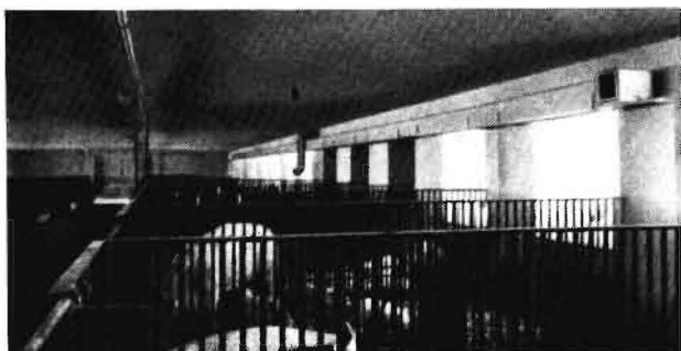
Bild 3. Im Stallinneren eingebauter Warmluftkanal
