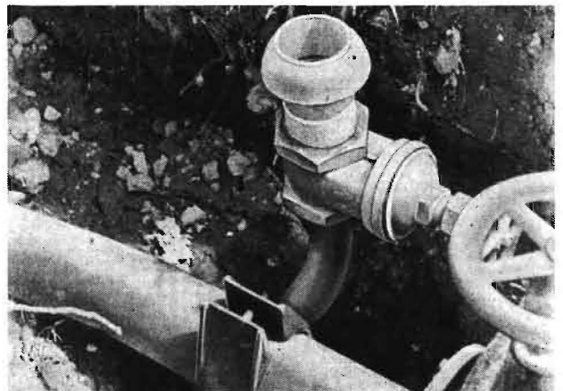
Bild 4. Hydrantenanschluß mit 3" Muffenschieber und V-Stück NW 80 mit Rohrschelle für Kardangelen-Schnellkupplung
