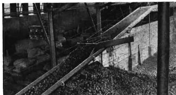
Bild 4. Beschickung des Zwischenlagers vom Hauptförderband, im Hintergrund Flachpaletten zum Sacktransport
