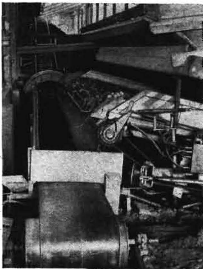
Bild 3. Annahmeförderer (rechts), Hauptförderband, Ringelevator und Zwischenbunker
