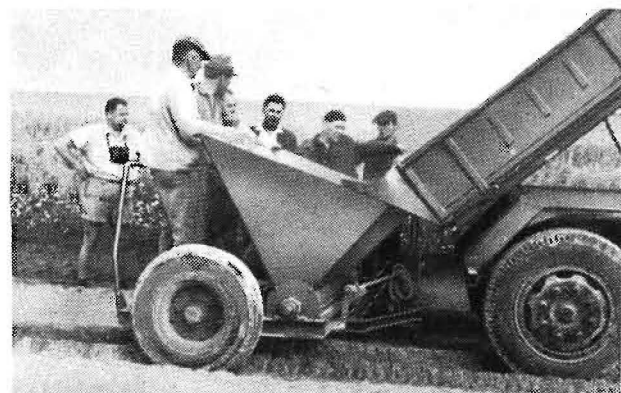
Bild 1. Anhängerverteiler mit Zellenradschleuse Füllung erfolgt vom Hinterkipper aus
