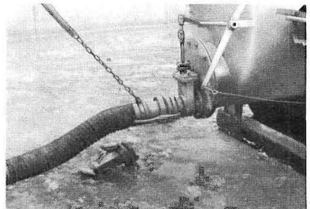
Bild 4. Flüssigmisttankentnahmestelle mit fest eingebautem Saugrohr. Der Verbindungsschlauch wird durch eine abgedeckte Kette unterstützt. Ein Zwangsanschlag auf der Fahrbahn sichert den richtigen Standort des Fahrzeuges beim Kuppeln des Schlauches
