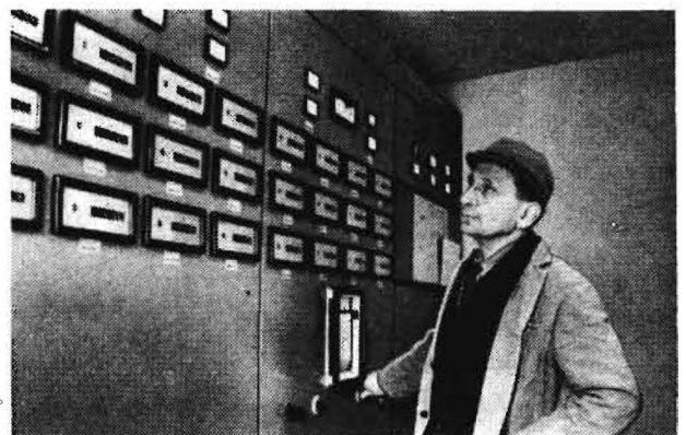
Bild 8. Meßwarte des NH 3 -Tanklagers im agrochemischen Zentrum Schafstädt (Foto: Eckstein)
