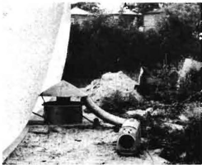
Bild 2. Belüftungsgebläse und Heizaggregat am Tragluftzelt
